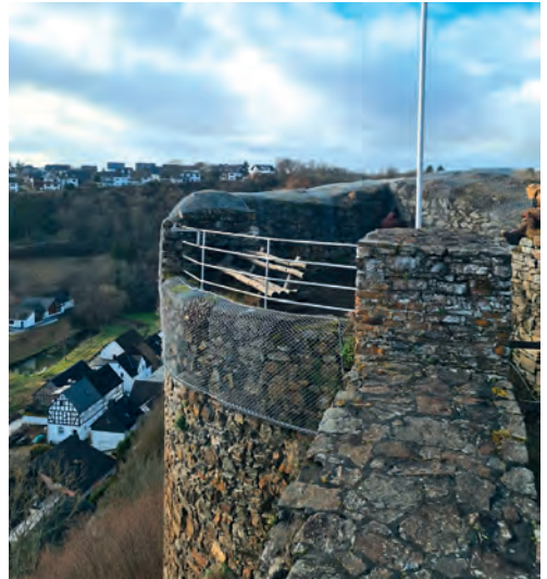
Rundturm der Virneburg: Ein Drahtnetz schützt vor Steinschlag © Felsbau Schneider
